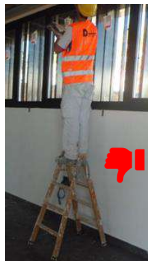
No trabajar sobre los últimos peldaños
